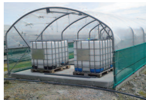
La cuve tampon sécurise l'installation de traitements des effluents phytos : ici des cuves PEHD se déversent par gravité dans un phytobac.
