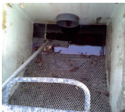
Le dégrilleur est un plus pour retenir les plus gros éléments
